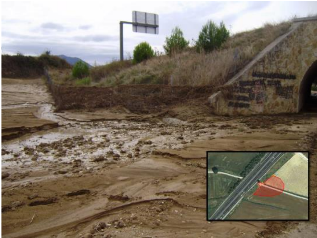
Figura 11. Los derrubios aguas arriba del paso de la regata de Arantzadia bajo la autovía AP-12, dejan constancia del efecto presa de dicha infraestructura viaria, así como de los importantes calados alcanzados.
